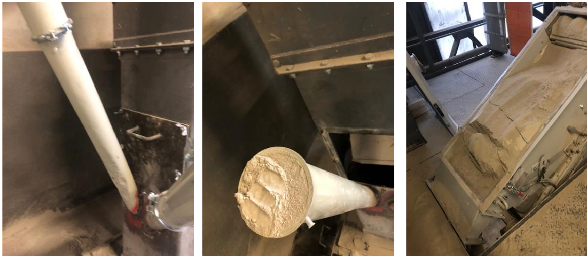
Abbildung 2-13 Gestörter Materialtransport im Umlaufbetrieb. Links: Materialzufuhr zum Umlaufbecherwerk. Mitte: Verstopfte Überlaufleitung. Rechts: Überfülltes Sieb aufgrund zugesetzter Überlaufleitung.
