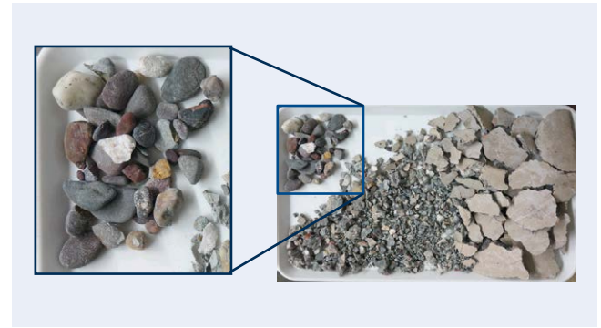
Bild 9: Abgeplatzte Betonbruchstücke (FB 6); Gesteinskörnung frei von Zementstein (links)
