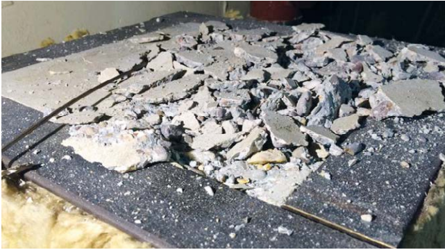
Bild 8: Oberfläche des Probekörpers FB 6 nach dem Abplatzen Figure 8: Surface of the FB 6 specimen after spalling
