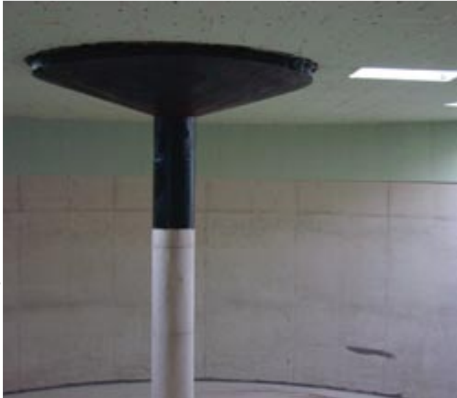
Bild 6: Beschichtung und Wärmedämmung im Fermentergasraum
