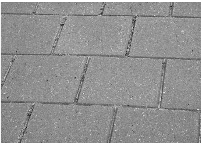
Bild 7: Ausblühungen nach 36 Monaten
