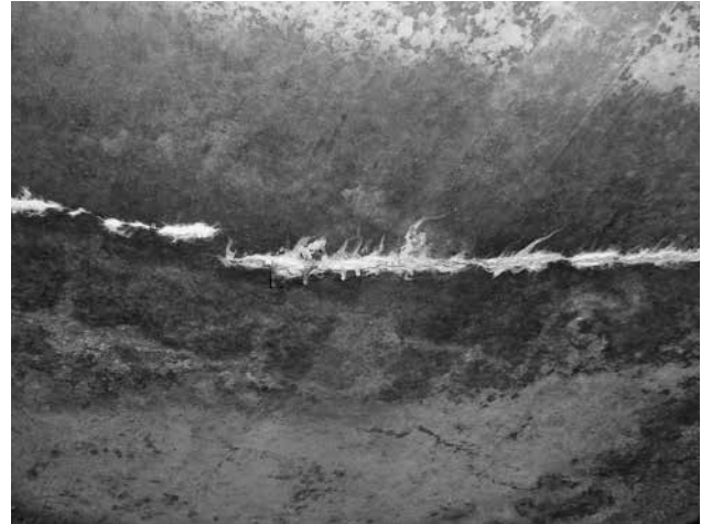
Bild 2: Aussinterungen an einem Deckenriss
