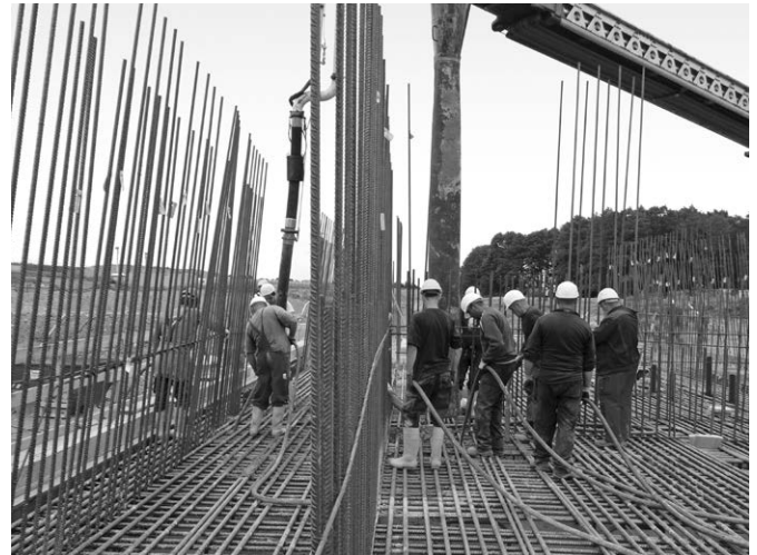
Bild 10: Fundament eines Hochwasserrückhaltebeckens in zonierter Bauweise, links im Bild wird der Randbeton C30/37 (auf Grund der Expositionsklasse XA2) und rechts der Kernbeton mit geringer Festigkeits- und Wärmeentwicklung eingebaut (Foto: A. Weisner).
