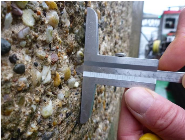
Bild 9 Bestimmung der Abwitterungstiefe an einer Kammerwand von Schleuse 3
