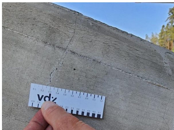
Bild 18 Risse mit Rissbreiten < 0,3 mm in der Bogenkonstruktion von Brücke 3
