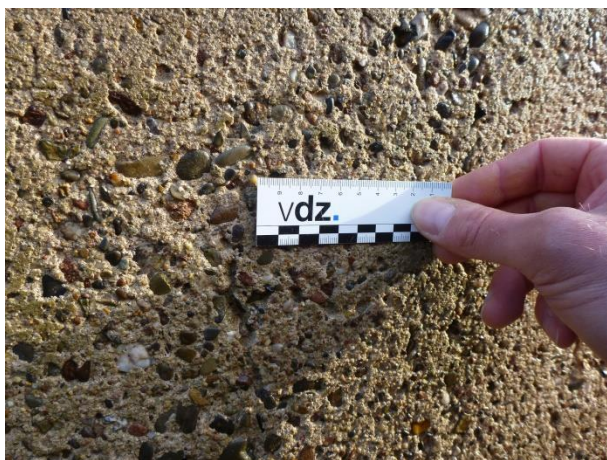
Bild 5 Stark abgewitterte Oberfläche im Bereich der Wasserwechselzone Schleuse 2
