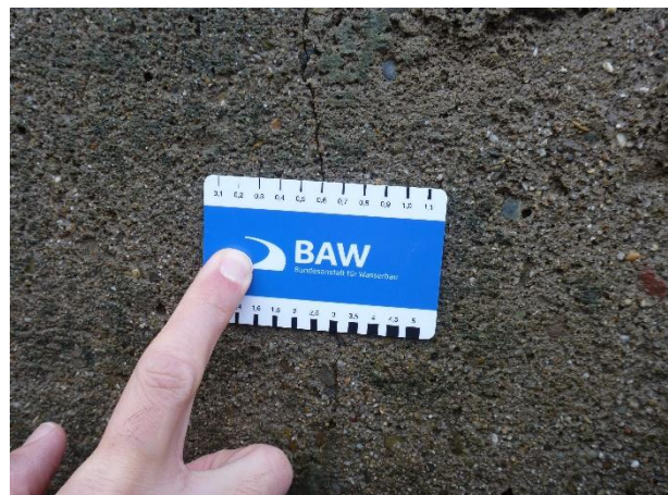
Bild 12 Vertikalriss in einer Kammerwand von Schleuse 1 mit einer Rissbreite bis 0,6 mm
