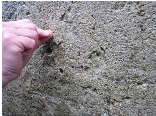
Bild 10 Durch Frostangriff geschädigte Betonoberfläche einer Kammerwand von Schleuse 3
