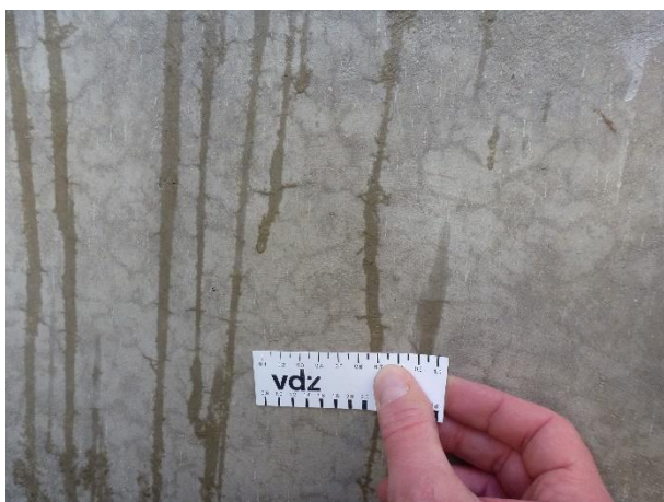
Bild 28 Netzrisse mit Rissbreiten von 0,05 bis 0,1 mm in Wandflächen von Hochbau 1
