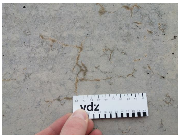
Bild 29 Risse mit Rissbreiten von 0,05 bis 0,1 mm an Außenstützen von Hochbau 4
